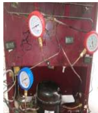
Fig.1(A) existing condenser
